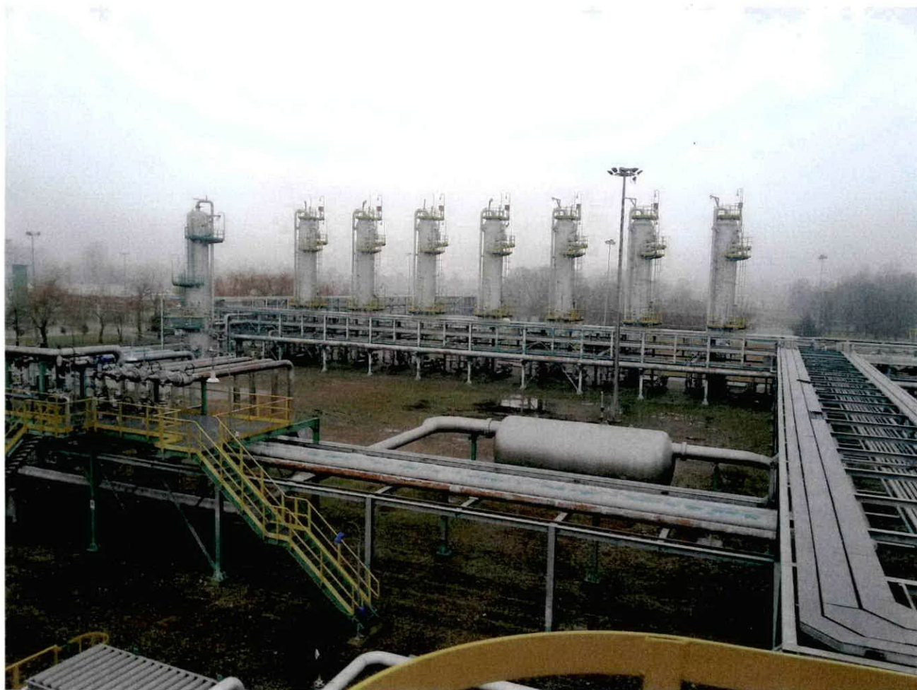
Centrale “Settala Stoccaggio”
