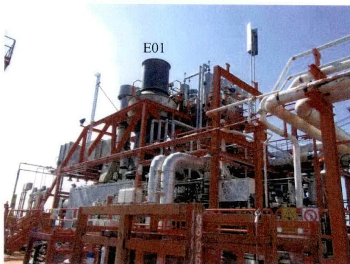
Foto 2 - Punto di emissione attivo E01
