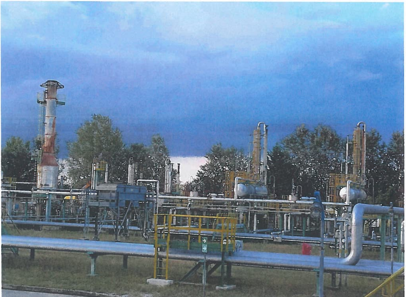
Centrale “Ravenna Mare”: Termodistruttore e Rigeneratori TEG
